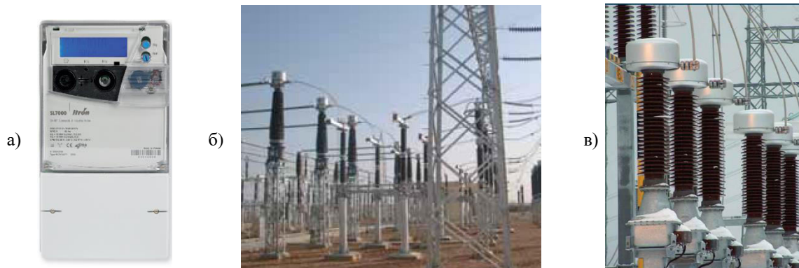
Слика 1 – а) Често коришћено бројило електричне енергије у индустрији и трансформаторским станицама и разводним постројењима, класе 0,2 S или 0,5 S за активну електричну енергију са деветоцифрским екраном, које се прави за константу 10000 imp./kWh за бројила за индиректни прикључак преко мерних трансформатора [4] [3]. б) Струјни мерни трансформатори за највиши напон 245 kV [5] [4]. в) Индуктивни напонски мерни трансформатори за највиши напон 123 kV [5] [4].
